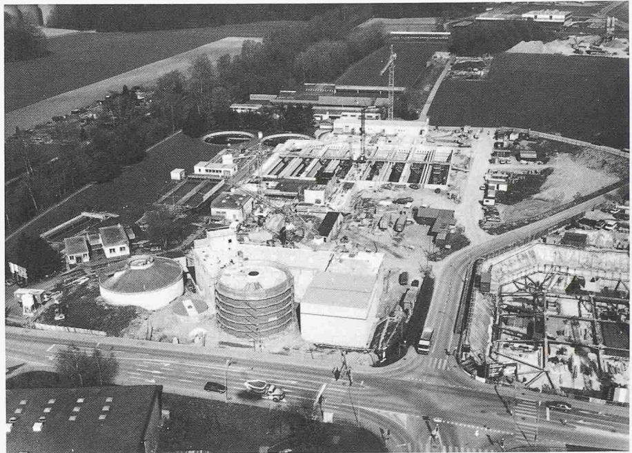
Die Glatt, einer der am stärksten belasteten Flüsse der Schweiz, muss entlastet werden. Der Bau der Kläranlage Kloten-Opfikon, die auch die Abwässer des Flughafens klären wird, soll dazu beitragen (Bild: Comet)
