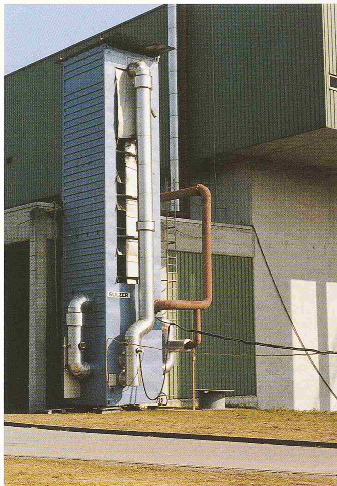
Bild 5. Ansicht der \text{DeNO}_x -Pilotversuchsanlage an der KVA Müllheim zur Entstickung von Rohgas mit mehr als 120 \text{ mg Staub}/\text{Nm}^3
