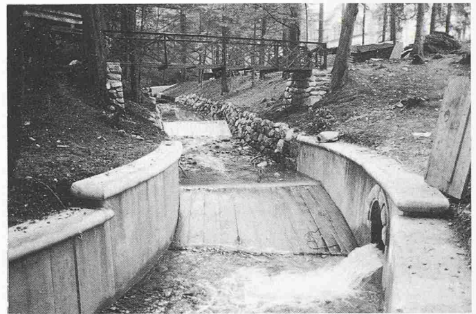
Bild 16. Die Unterhaltsstrecke am Wissenbach nach Ende der Sanierungsarbeiten 1987. Die Ufermauer rechts im Bild ist mit Spritzbeton aufprofiliert, die linke vollständig erneuert worden. Die Rampen aus Eichenholz sind in Anlehnung an frühere Bauverfahren rekonstruiert worden.
