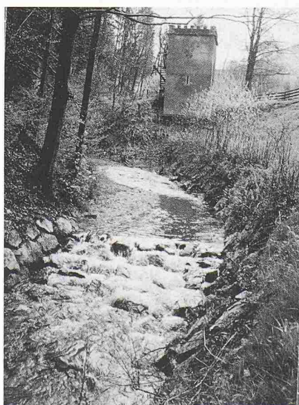
Bild 17. Neuer Uferschutz mit Blockrampe am Wissenbach. Die Konstruktion mit Blöcken entspricht den neuen Erkenntnissen des naturnahen Gewässerausbau. Im Hintergrund der Turbinenturm der Seiltransmission.
