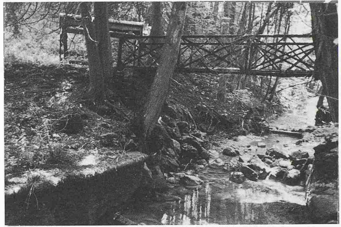
Bild 14. Das Teilstück des Wissenbachs, für dessen Unterhalt der Inhaber des Wasserrechts verpflichtet ist, vor der Instandsetzung der Ufermauern. Die Verbauungen waren teilweise eingestürzt, weshalb die Uferböschungen bei Hochwasser durch Erosion gefährdet waren.
