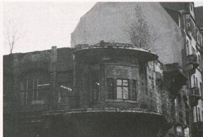
Bild 4. Gebäude nahezu in Auflösung, dennoch werden die Räume noch genutzt (Neonbeleuchtung!)
