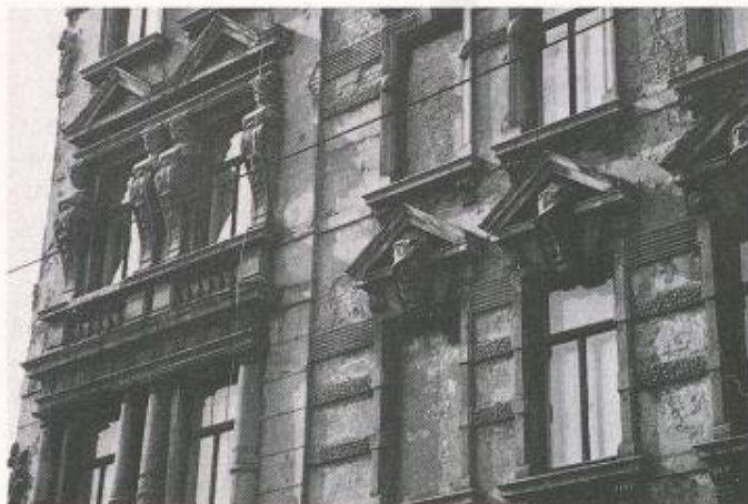
Bild 3. Zerfallende Hausfassade und entsprechend Einsturzgefahr
