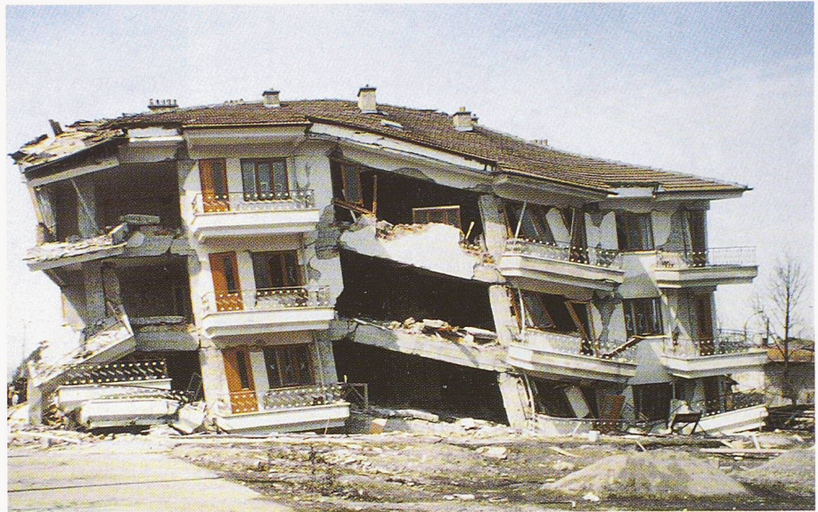
Bild 11. Stahlbetonskelettneubau mit Backsteinaufmachungen. Auffällig sind die Trennrisse und Betonzerstörungen in den Gelenkbereichen
