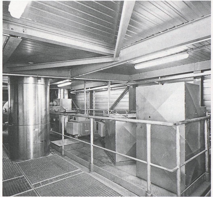
Bild 4. Oberer Teil des Elektrofilters mit Hochspannungsteil
