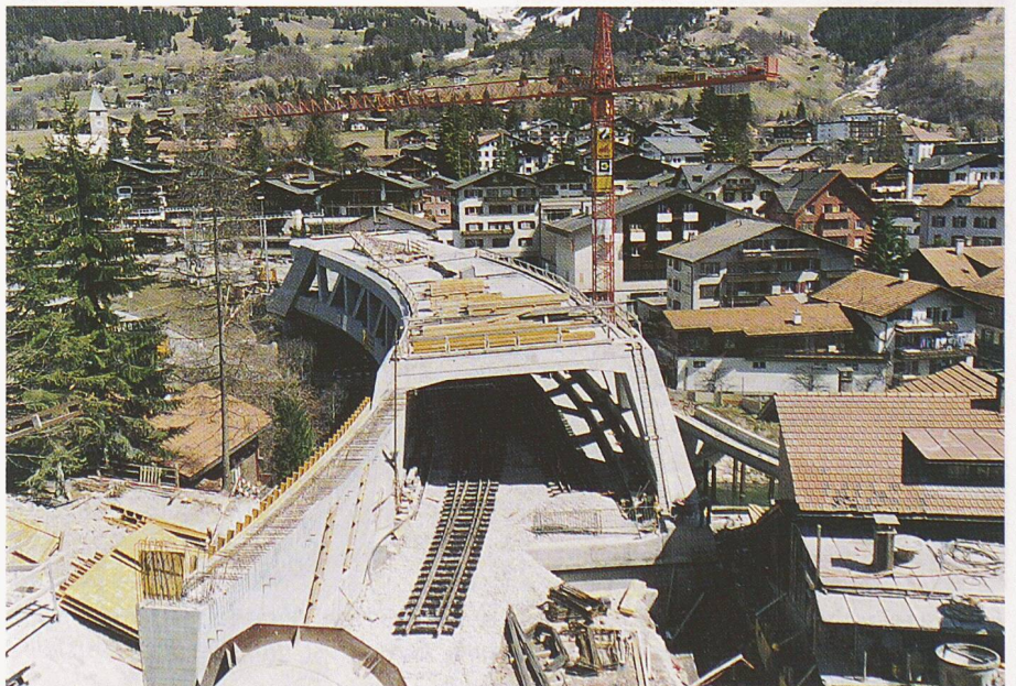
16 Stunden später: Die Brücke ist 10 Meter flussabwärts verschoben. Gleisbau Seite Davos
