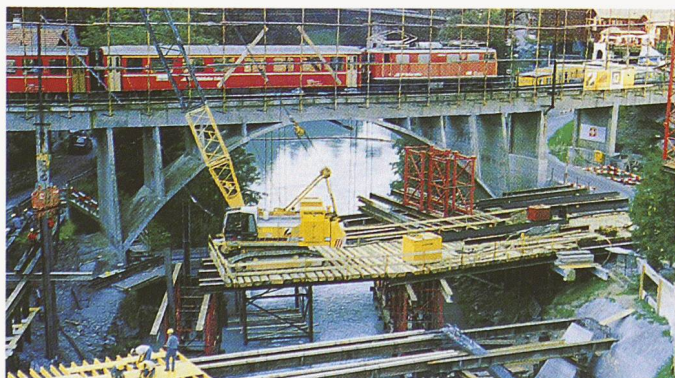
Blick auf die alte Bogenbrücke mit Zugeinfahrt in den Bahnhof Klosters, auf Dienstbrücke/Lehrgerüst und auf die Fussgängerbrücke im Bau (August 91)
