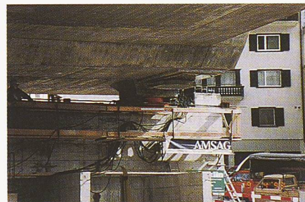
Bild 2. Abstützung des Brückenträgers über das rote Taktshublager auf den Querverschubträger (Foto: F. Gruber)
