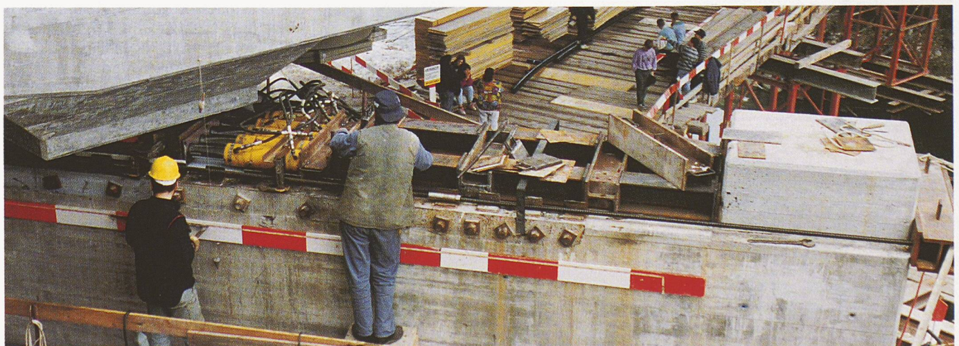
Bild 4. Querverschubbahn Seite Davos mit Abstütznocken, Füllelementen, Pressenbatterie und Führungswinkeln; aktuelle Verschubdistanz 3,6 m (Foto: Zschokke)
