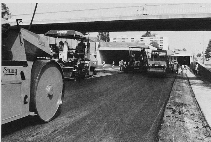
Bild 5. Einbau Splittmastix mit drei Fertigern bei gesperrter Fahrbahn, Bereich Südportal (Mai 1992, Foto M. Frick)
