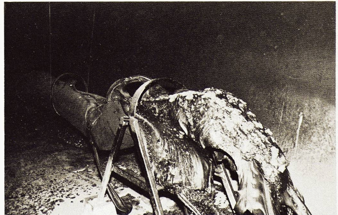
Bild 5. Brückenentwässerung Hauptleitung verbrannt und geschmolzen
