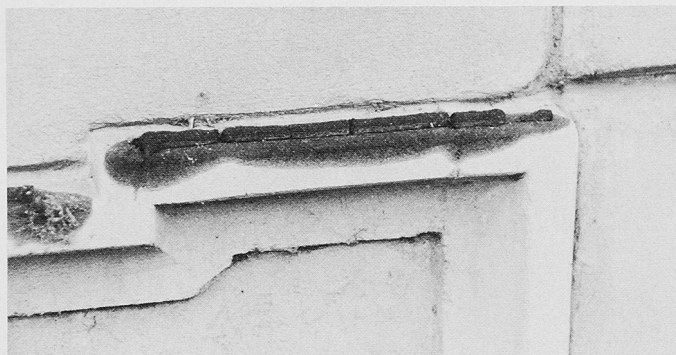
Bild 1. Schäden durch Taubenschutz-Pasten
