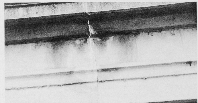
Bild 8. Schäden durch offene Fugen
