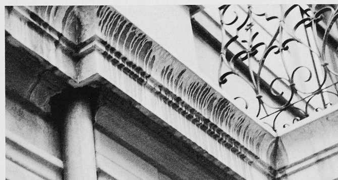
Bild 7. Kalkaussinterungen, unabgedeckte Gesimse
