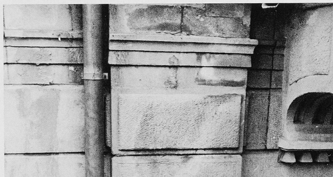
Bild 5. Schäden durch defekte Dachwasserrohre
