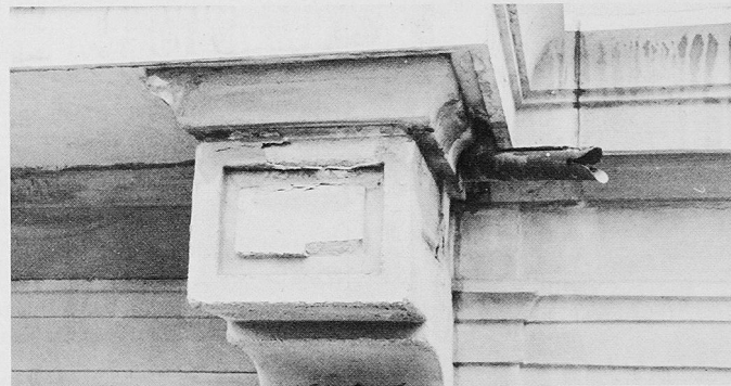
Bild 4. Zerstörte Profilierung, falscher Wasserabfluss
