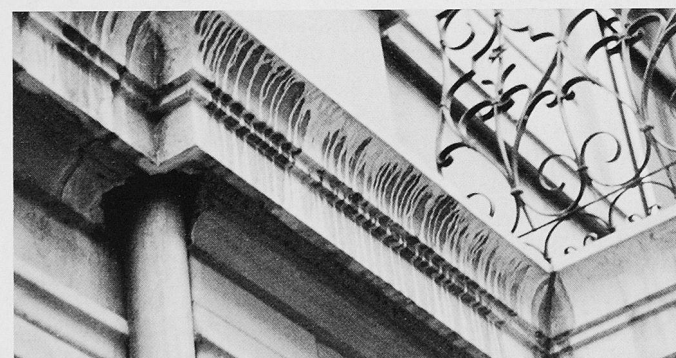
Bild 7. Kalkaussinterungen, unabgedeckte Gesimse
