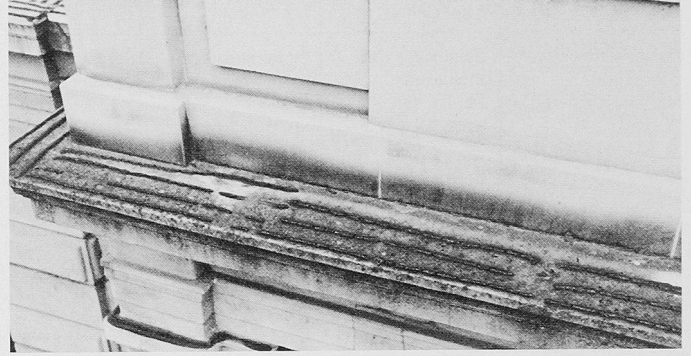
Bild 2. Schäden durch unabgedeckte Gesimse
