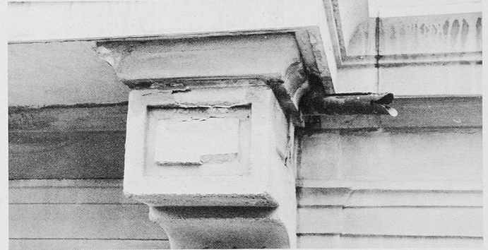
Bild 4. Zerstörte Profilierung, falscher Wasserabfluss
