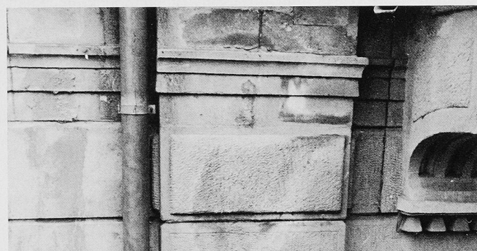
Bild 5. Schäden durch defekte Dachwasserrohre
