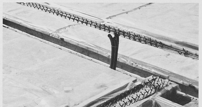
Bild 4. Neubau Schulhaus Eidmatt III in Wädenswil (Hurter &amp; Thoma, Wädenswil). Plastikfolien verhindern die Verschmutzung der Akustikdecke und der Brett-schichtholzträger mit Zementmilch. (Foto: U. A. Meierhofer, EMPA, Dübendorf)
