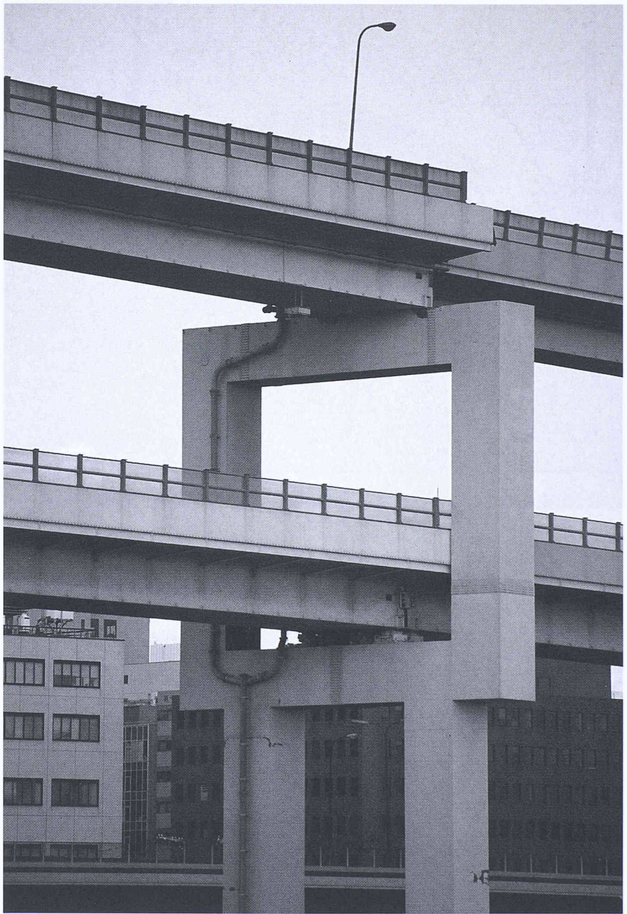
Bild 12. Beinahe-Absturz des oberen Brückenträgers
