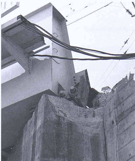
Bild 13. Aus der Verankerung gerissenes Horizontalkraftlager einer Eisenbahnbrücke
