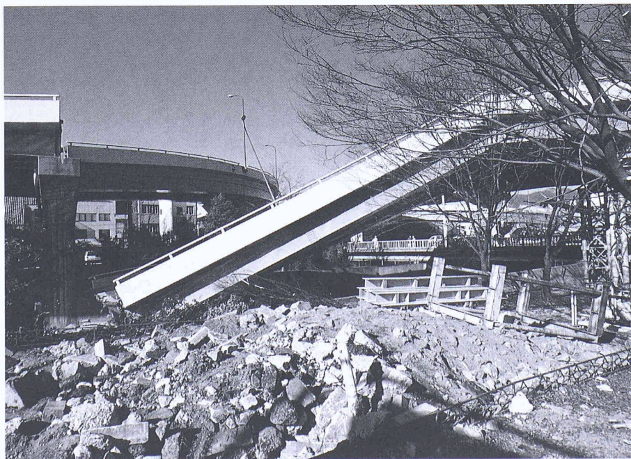
Bild 11. Absturz des Trägers einer Verbundbrücke
