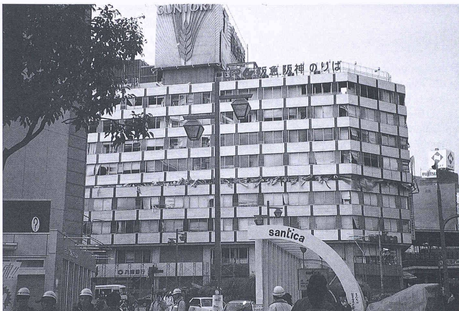
Bild 17. Geschäftshaus mit Mittelgeschosseinsturz
