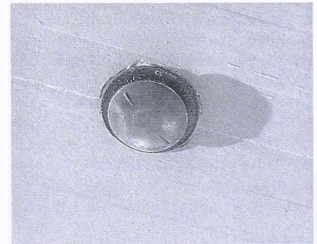
Bild 7. Kugelförmiger Luftauslass in der Küche (Beispiel Riehen)
