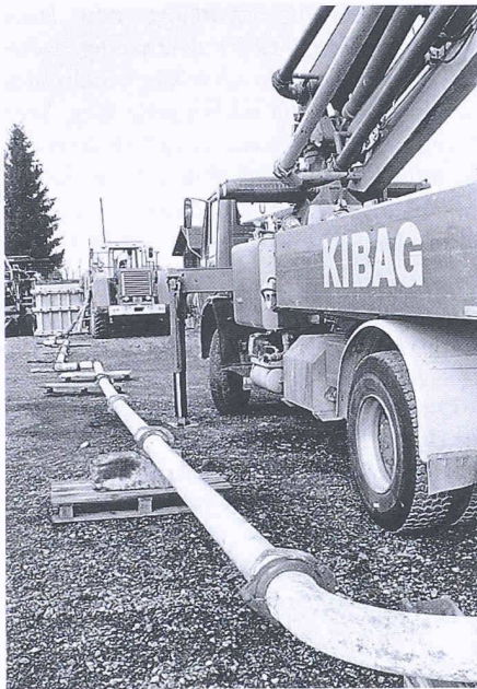
Bild 2. Pumpe und Pumpleitung
