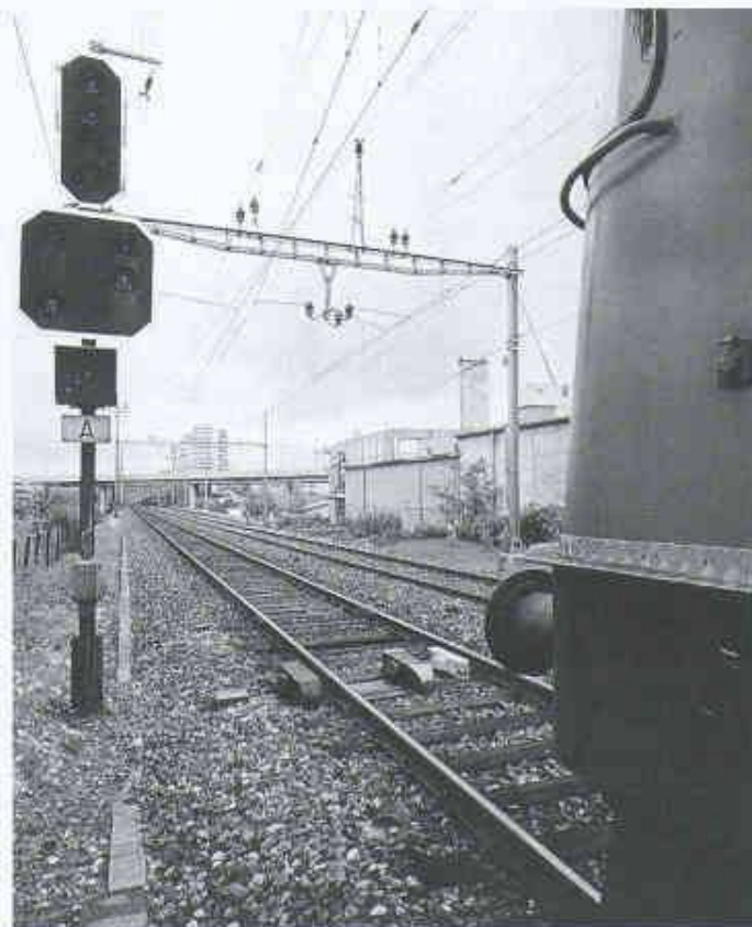
5 Gleisausrüstung für die Systeme Signum und ZUB
