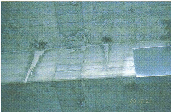
Korrodierte Spannkabel oberhalb der Hohlstrasse
