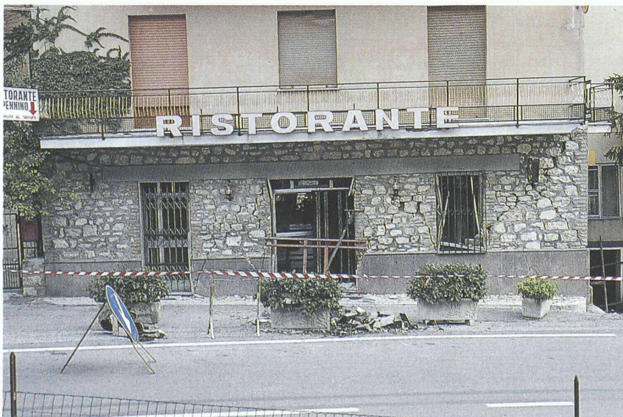
Hotel mit Restaurant: grobe X-förmige Risse in den kurzen Natursteinwänden im Erdgeschoss
