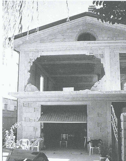
10 Herausgefallene Mauerwerksausfachung eines Einfamilienhausneubaus
