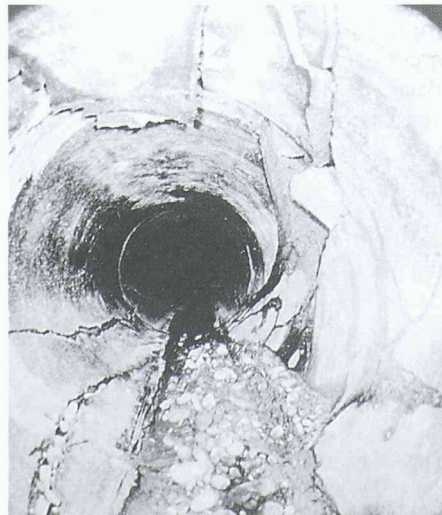
Stark zerrissenes Rohr, das einzustürzen droht
