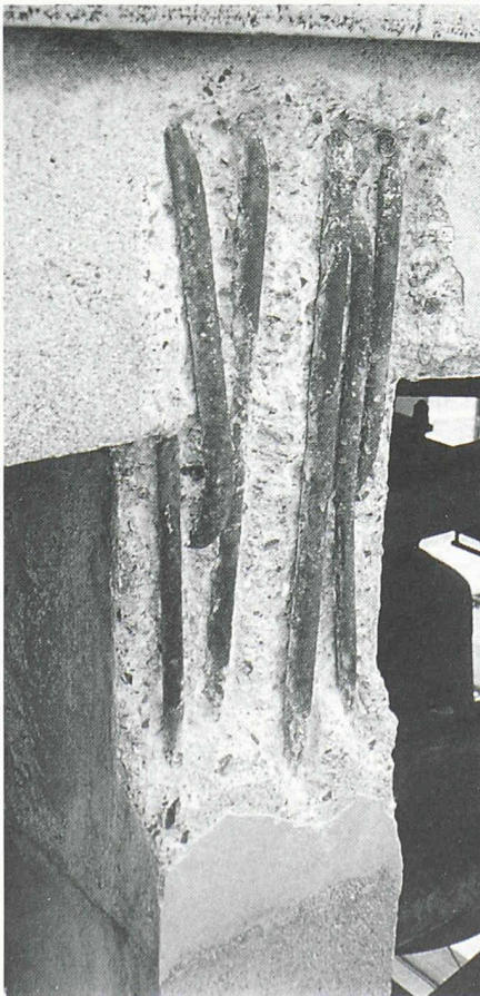
Schadstelle am Übergang einer Stütze des Turmaufbaus zum Turmdach
