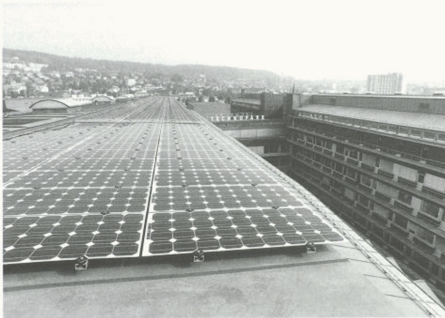
Solarstromanlage auf dem Dach des Technoparks Zürich. Die Dachfläche wurde an eine Betreiberfirma vermietet; die erzeugte Elektrizität fliesst in die Solarstrom-Börse der Elektrizitätswerke der Stadt Zürich (Bild: Comet)
