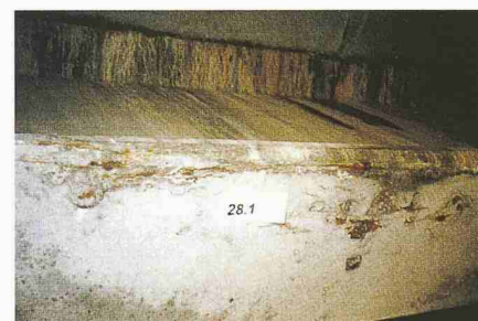
5 Schäden an Elementträger Nr. .1 und .5 (unten)
