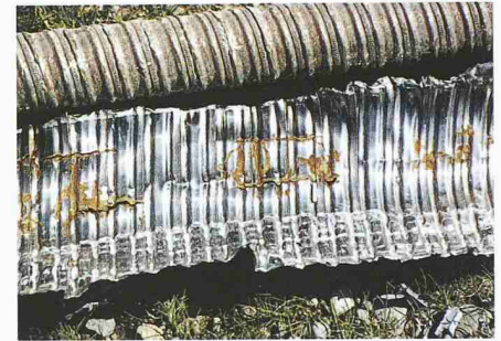
11 Hüllrohr aussen: keine Korrosionsspuren, Hüllrohr innen: Rostflecken
