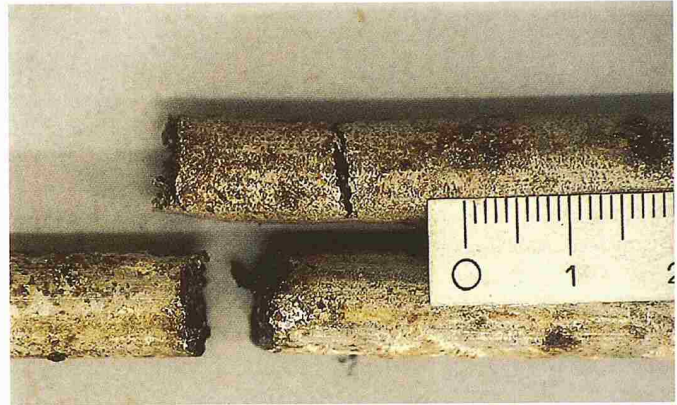
2 Befestigungsbügel der abgehängten Decke des Hallenbads Uster mit Korrosions- rissen, deutlich ist das spröde Bruchverhal- ten erkennbar
