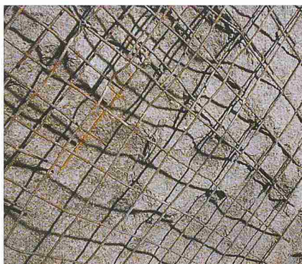
1 Zerstörter Beton und freigelegte Armierung nach Brandbelastung
