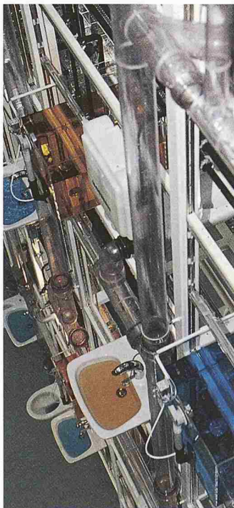
Die 12 Meter hohe hydraulische und transparente Demonstrationsanlage fasziniert die Besucher im Innern des neuen Geberit-Informationszentrums
