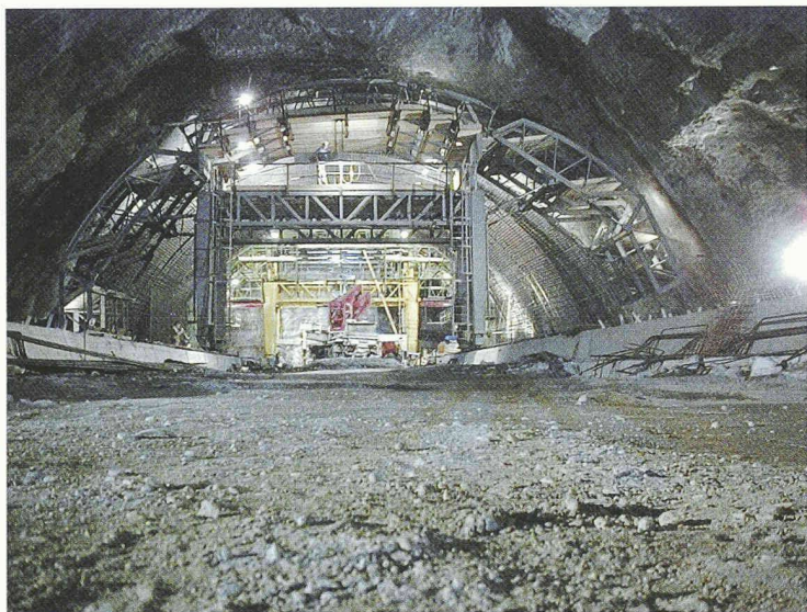
Betonierung der unterirdischen Zentrale Deriner - Türkei (H = 12 m, B = 30 m, L = 120 m)
