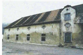
Der sanierungsbedürftige Marstall des Klosters Einsiedeln, Aussenansicht und Blick in die Stallungen (Bilder: pd)
