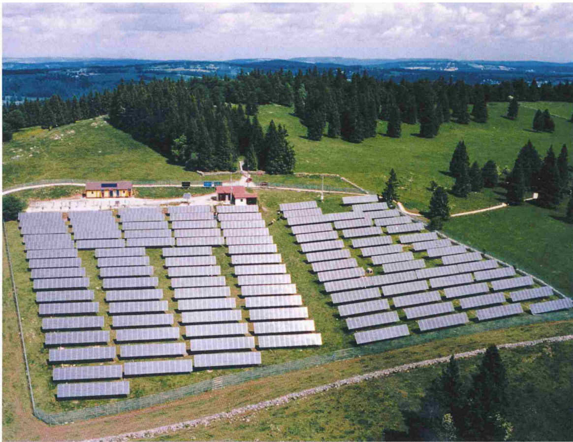
Photovoltaikpark Mont-Soleil: Schafe leben innerhalb der Anlage und halten die Vegetation in Schach. Damit verhindert man, dass die Paneele überwuchert werden (Bild: BKW FMB Energie AG)
