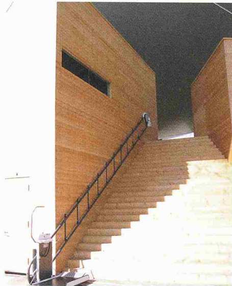
Der Treppenlift «Rigert-Pegasus» erschliesst gehbehinderten Menschen die Piazza Pinocchio auf der Artepilge Neuenburg
