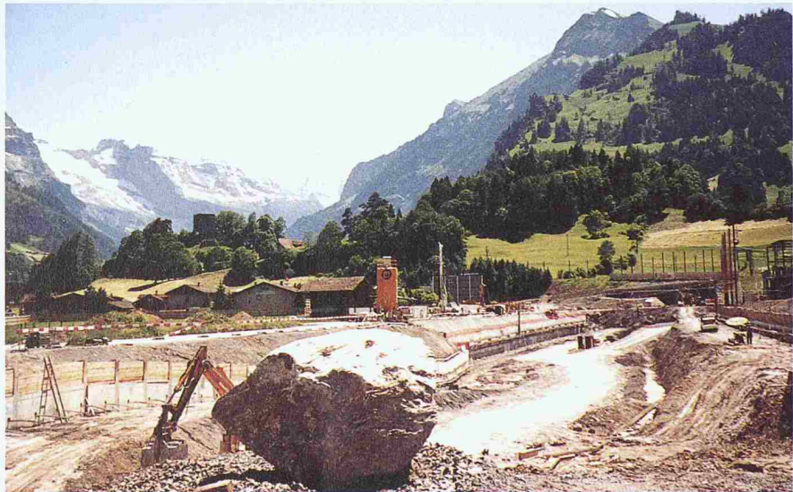
Bau der offenen Interventionsstelle bei Frutigen. Bei Unfällen erleichtert die in einem offenen Graben anstatt durchgehend im Tunnel geführte Strecke den Zugang zur Unfallstelle (Bilder: Zoppet)
