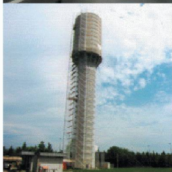
Behälter- und Bäderbau
