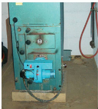
Diese Heizungsanlage gilt es demnächst zu ersetzen.
