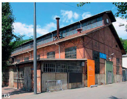
05 Die Schmiedehalle wurde 1906 erstellt und ist ein mit Backstein in Läuerschichten ausgefachter Stahlfachwerkbau unter einem Satteldach. Der offene Dachstuhl besteht aus Stahl und hat eine für die ursprüngliche Nutzung als Schmiede typische hohe Firstlaterne. In Baden sind alle anderen Hallen dieses Bautyps abgebrochen worden, die Schmiedehalle ist der letzte erhaltene Zeitzeuge. 2005 wurde das nahe Umfeld der Halle neu gestaltet (Schmiedepplatz-Gestaltung). 2011 wurde die Haupthalle der «Alten Schmiede» als industriegeschichtliches Zeugnis unter kantonalen Schutz gestellt (Foto: Jurybericht)
