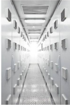
Batterien sind eine Option für die Speicherung von überschüssigem Strom aus Wind- und Fotovoltaikanlagen. Den bisher grössten Batteriespeicher der Schweiz testen die Elektrizitätswerke des Kantons Zürich (EKZ) seit diesem Frühjahr in Dietikon (Foto: Hannes Henz)
