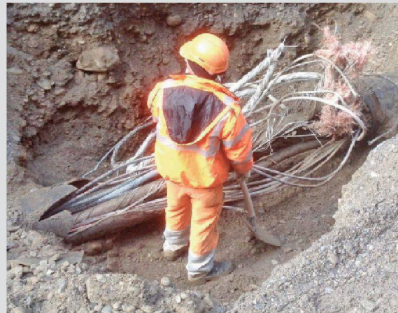
In der Berner Marktgasse beschädigte ein Bagger im April 2013 auf einen Schlag Tausende Glasfasern und Kupferadern.
