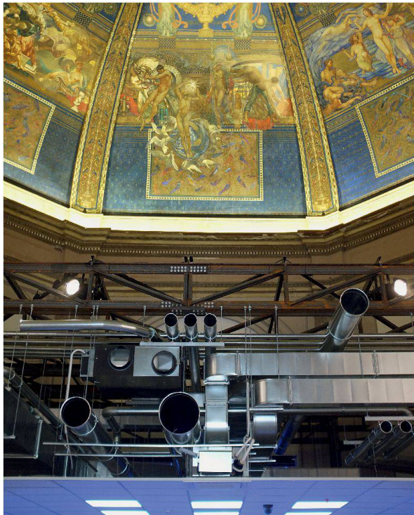
Realität und Ästhetik im Raum «Ceiling»: das Deckengemälde von Galileo Chini von 1909 über einer technischen Installation.
