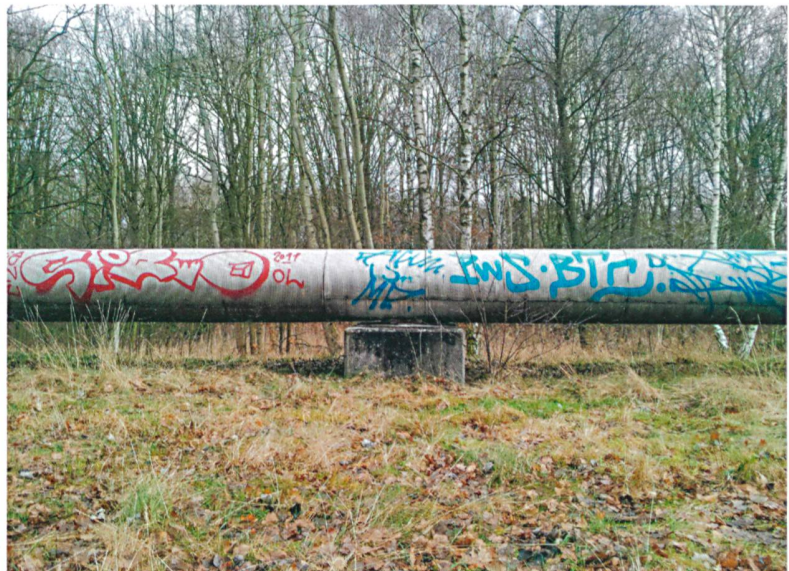
Überirdisch verlegte Fernwärmeleitung in Bremen.
