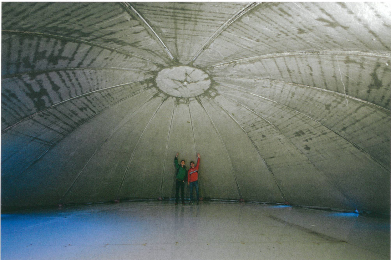
Die fertiggestellte Schale hat im Innern eine Höhe von 3.5 m, ihre Fugen sind mit Mörtel verspachtelt.
