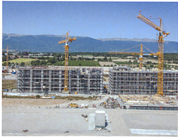
Das Ökoquartier «Les Vergers» in Meyrin GE mit 34 neuen Gebäuden für total 3000 Bewohner ist derzeit im Bau.
