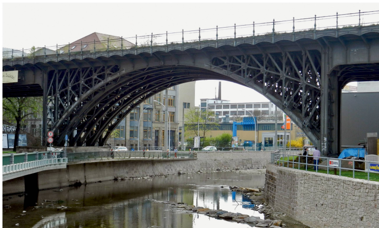
Für das ebenfalls bedrohte Chemnitztalviadukt setzt sich eine Bürgerinitiative ein.
