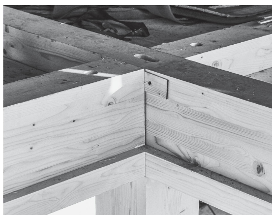
Die Knotenverbindung des Rasters bleibt im Endausbau unsichtbar. Da der Zugang eingeschränkt war, kamen nur kleine Bauteile zum Einsatz.
