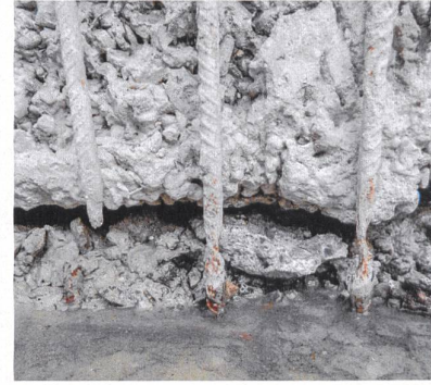
Hauptbewehrung eines Stützbauwerks mit erheblichem Korrosionsgrad und Querschnittsverlust.
