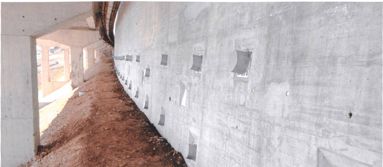
Oben: A9 bei Le Lanciau VD: Verstärkung einer bergseitigen Nagelwand mittels vorgespannter Ankerwände.
