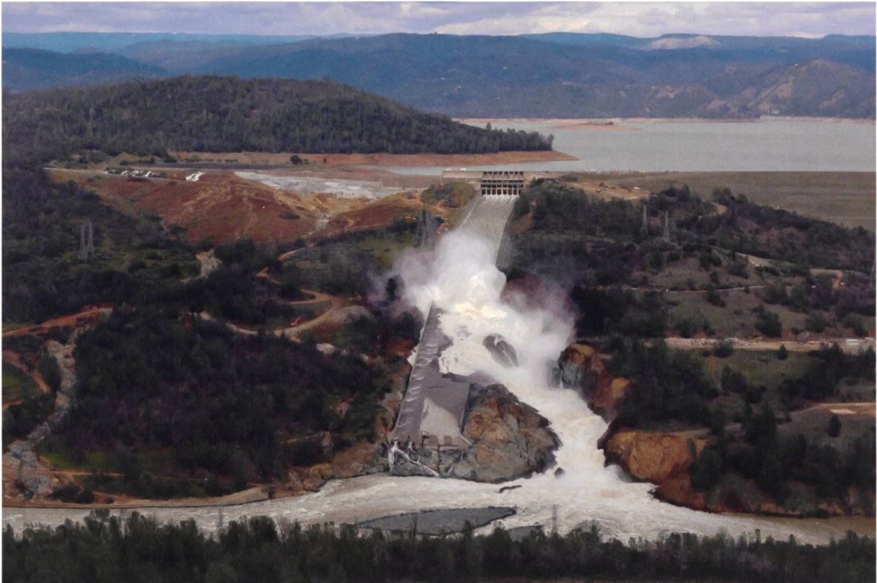
Luftansicht des Lake Oroville , 26. Februar 2017: Oben links ist derjenige Teil des Damms erkennbar, der als Überlauf ausgebildet ist, der Hang darunter ist teilweise stark erodiert. In der Bildmitte die Hochwasser-Notentlastung mit beschädigter Schussrinne .
