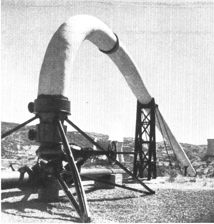
Der Erddampf ist gefaßt und wird den Fabriken im Hintergrund zugeführt. Die Röhren sind isoliert und ziehen sich stellenweise kilometerweit hin
