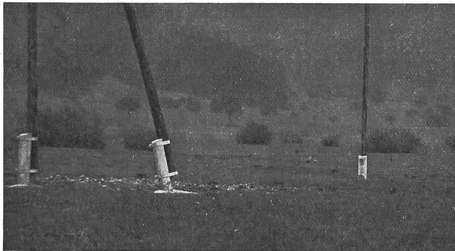
Fig. 9. Leitung auf „Universalsöckeln“ durch Sumpfgebiet.
