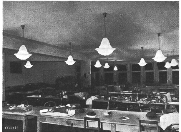
Fig. 3. Cortesca Jersey Manufacture, Zürich. Nähsaalbeleuchtung mittelst Mischlichtlampen HWA 500.
