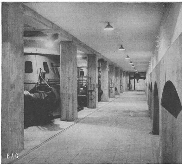
Fig. 17. Turbinenvorraum mit direkter Deckenbeleuchtung (Siehe auch Fig. 6.)
