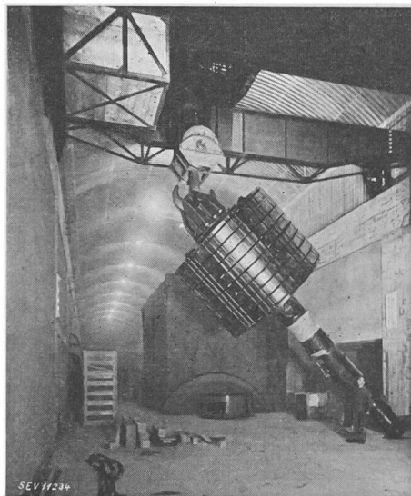
Fig. 4. Anheben des Rotors mit Welle mittels am Kupplungsflansch befestigter Aufhängevorrichtung (Vgl. Bull. SEV 1942, Nr. 20, S. 535, Fig. 13.)
