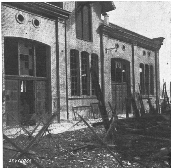
Fig. 6. Südfront des Kraftwerkes B mit Ueberresten der abgebrannten Baracke
